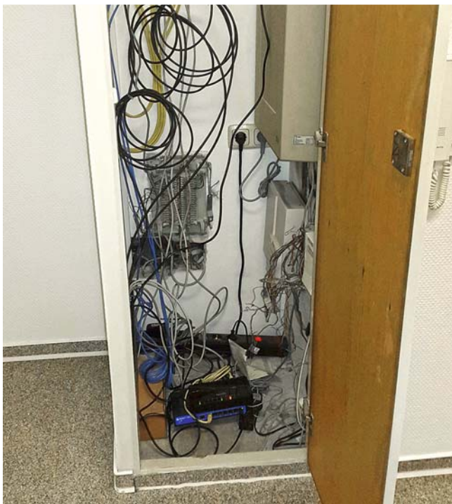
► Abb. 4 Netzwerk mit einem unübersichtlichen „Kabelsalat“
